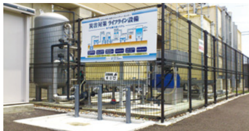
自治体関連施設では初めて納入された金田小学校(近江八幡市)のプラント
