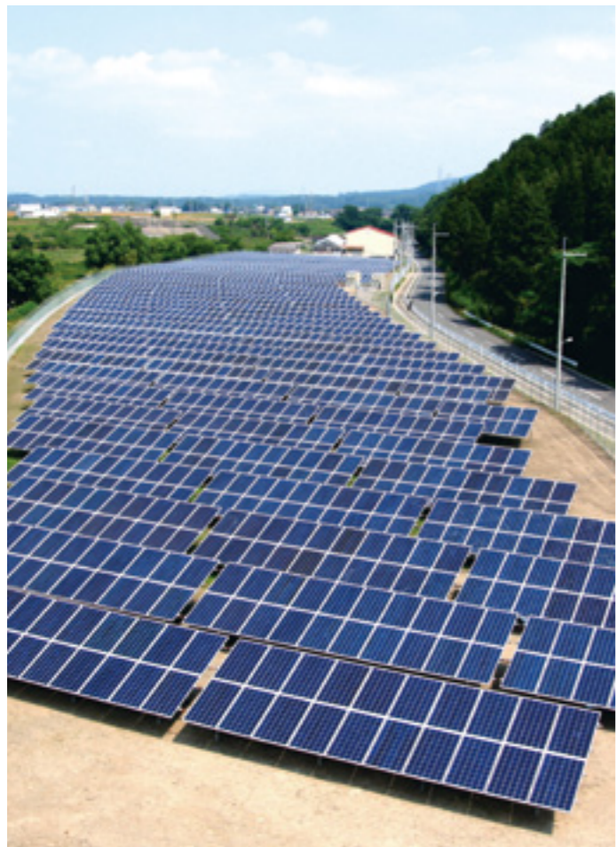
遊休地に設置された太陽光発電システム(東近江市山上町)
